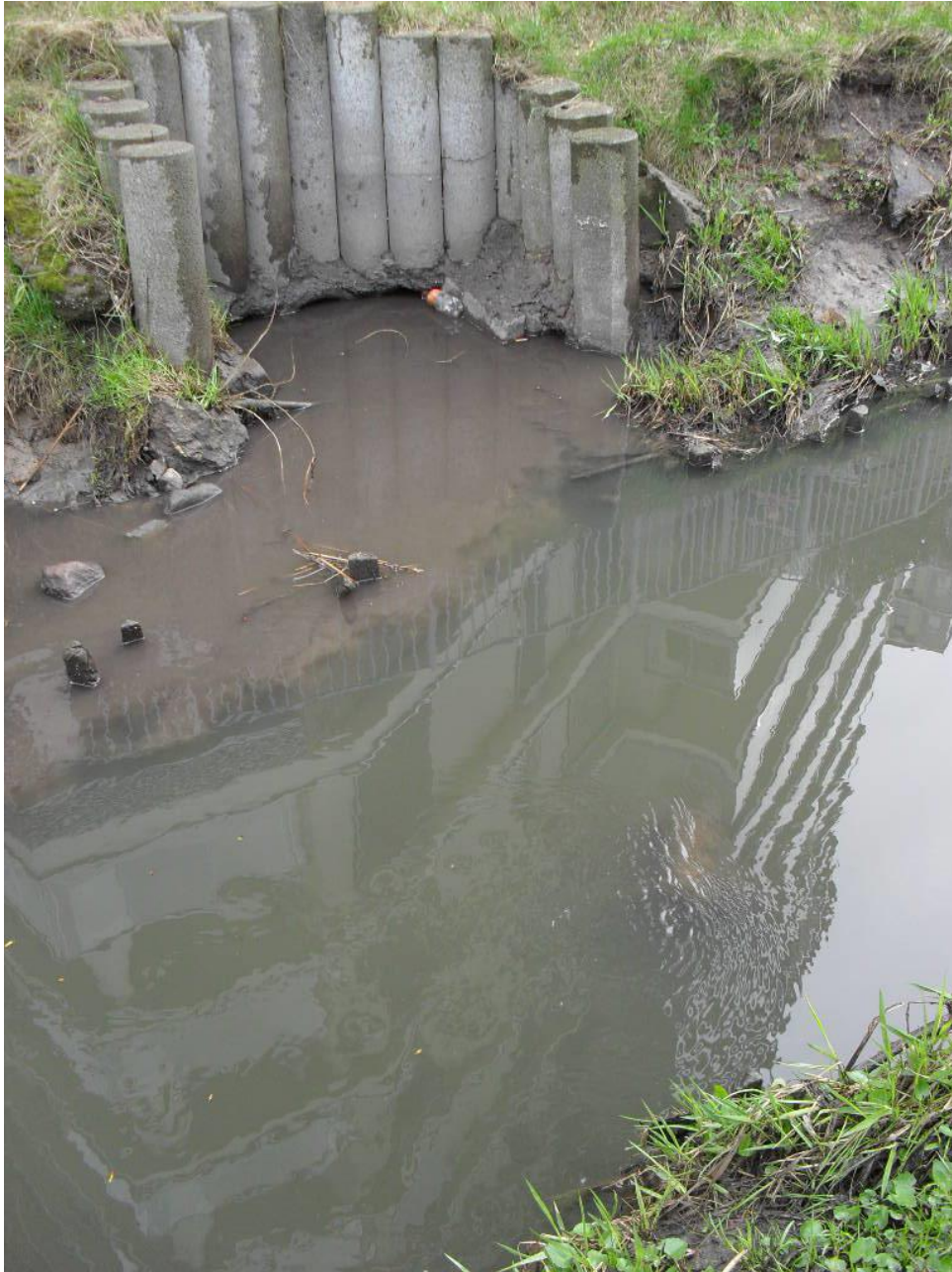
Fig. 18. Odpływ wody spod osiedla przy skrzyżowaniu ulic Rzymowskiego i Pallutha
